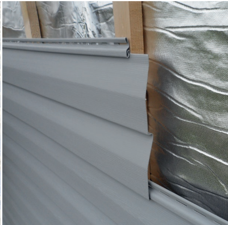
Fassade Konformitätskennzeichnung DIN EN 13859-2
